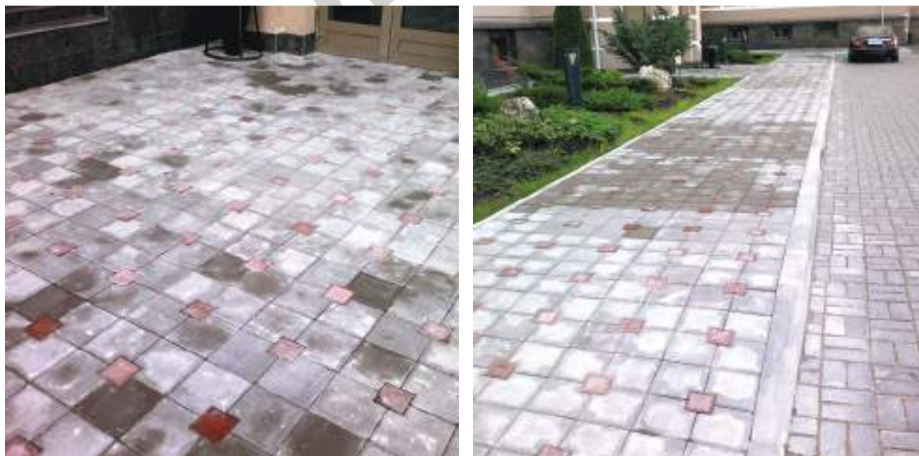
Рис. 7. Высолы на поверхности мощения (внешний вид покрытия в 2015 году).
