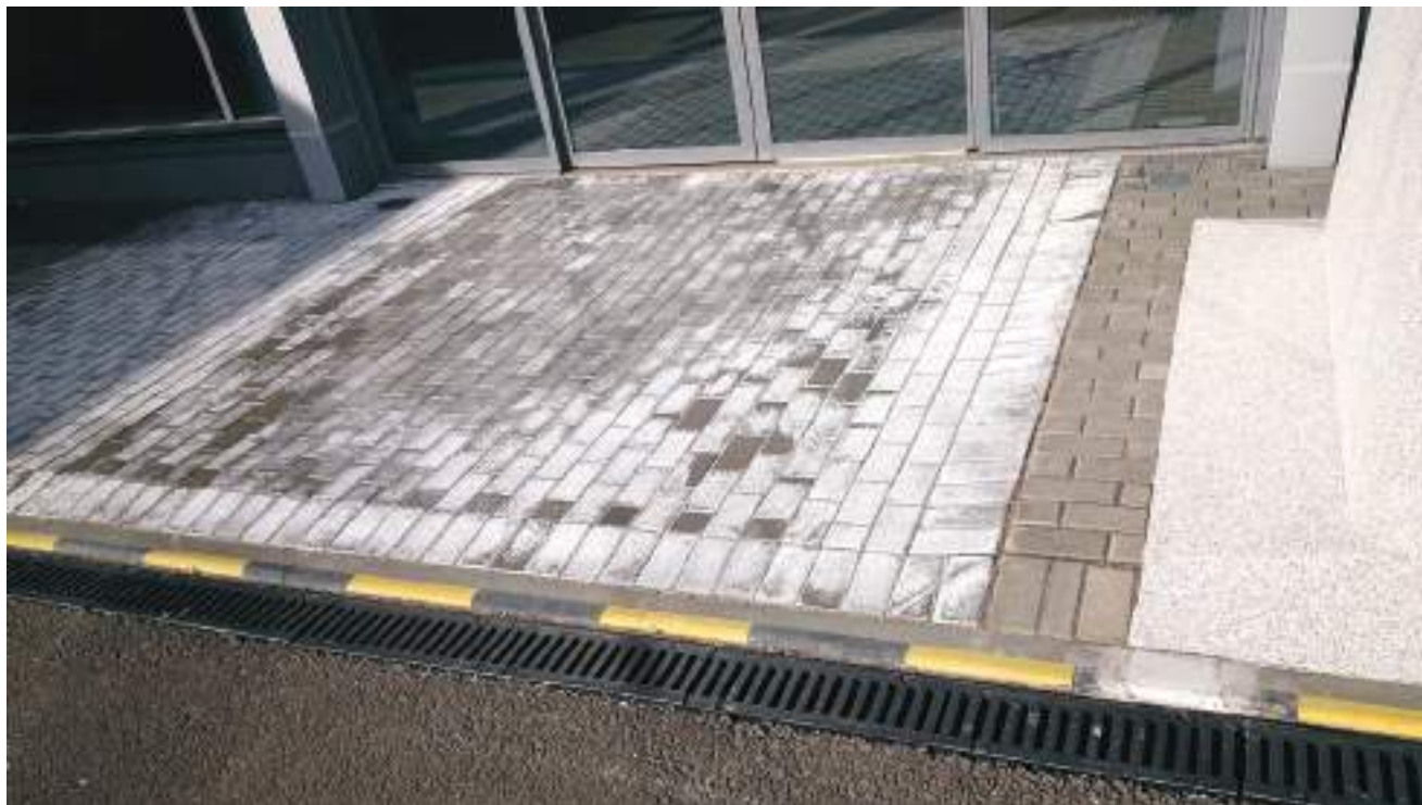
Рис. 6. Появление белых налетов на мощении из-за отсутствия отвода воды с бетонного несущего основания под плиткой.
