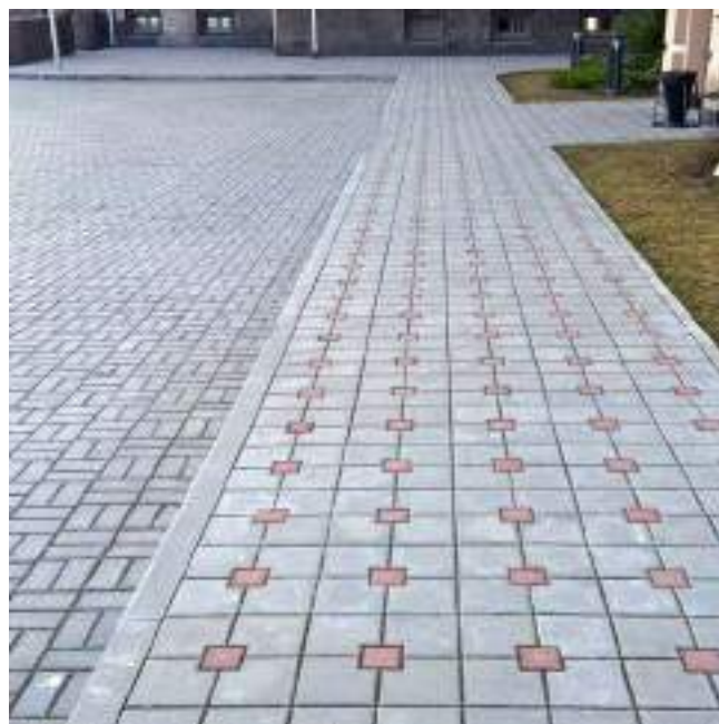
Рис. 9. Состояние в 2018 году. Высолы на поверхности мощения отсутствуют.
